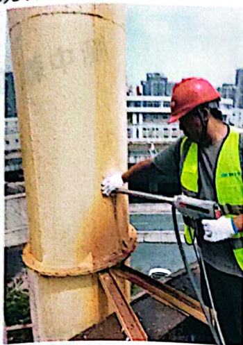
天然气锅炉排气筒
