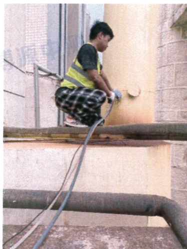
天然气锅炉排气筒
