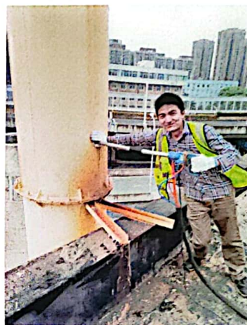
天然气锅炉排气筒
